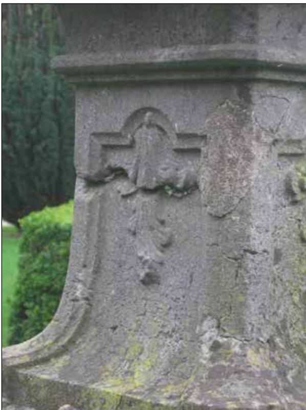
Figuur 25. Detail van een 18 de eeuwse sokkel met brandlaag, schadebeelden en reparatiemortel.
