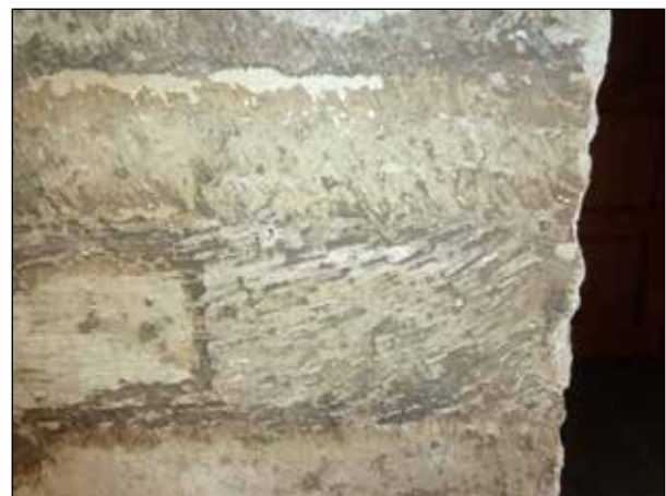
Figuur 2. Parementblokken van Ledesteen in de Hooglandse kerk Leiden; de kalklagen heeft men tijdens de restauratie in de jaren '30 van de vorige eeuw weggekap. Er is goed te zien hoe soms per laag of per blok een andere richting voor het kappen is gekozen. Tegelijk is ook zichtbaar dat de bewerking nog doorloopt over de voegen, waardoor duidelijk wordt dat het gaat om een bewerking die is uitgevoerd toen de blokken al gesteld en gevoegd waren. Het lijkt er op dat dit werk met een kaphamer of bijl is gedaan; met een vlakke beitel zou het ook mogelijk zijn, maar dan zouden de slagen elkaar meer opeenvolgen en minder verdeeld liggen over het vlak. Foto: H.J. Tolboom 2013.
