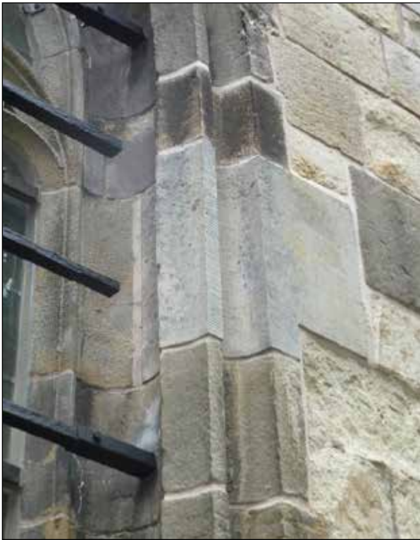
Figuur 5. In het midden van de foto is een blok zandsteen te zien, dat is aangebracht in 2010 aan de zuidoostzijde van het koor van de St.-Janskathedraal in 's-Hertogenbosch. Het blok is zo ingekleurd dat de structuur en de verweringskleur van de omliggende blokken worden gesuggereerd (welke dateren van de jaren '20 van de vorige eeuw), maar de bewerking van de omliggende blokken werd echter niet overgenomen.
