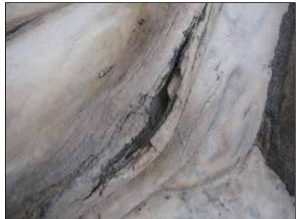
Figuur 8. Plooi in de jurk van de Amsterdamse stedenmaagd die zetelt in het midden van het timpaan aan de Damzijde van het paleis op de Dam. Waarschijnlijk door een verflaag is de steen aan het oppervlak verdicht en versuikerd even onder dit oppervlak. Door craquelé is uiteindelijk een opening ontstaan in de huid, waarlangs het versuikerde marmer is weggespoeld. Foto: H.J. Tolboom 2010.
