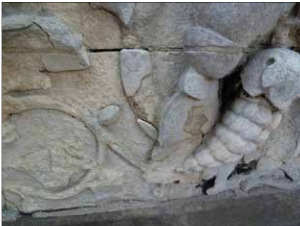
Figuur 11. Detail van de timpaanvulling van het pand Bleijenburg 38 in Den Haag. Herstellingen met mortel van 25 jaar geleden komen los of zijn er al afgevallen, doordat de ondergrond verder is verweerd. Het beeldhouwwerk was oorspronkelijk uitgevoerd in Banc Royal, een homogene fijnkorrelige Lutetiaankalksteen afkomstig uit de omgeving van Parijs. Foto: H.J. Tolboom 2012.
