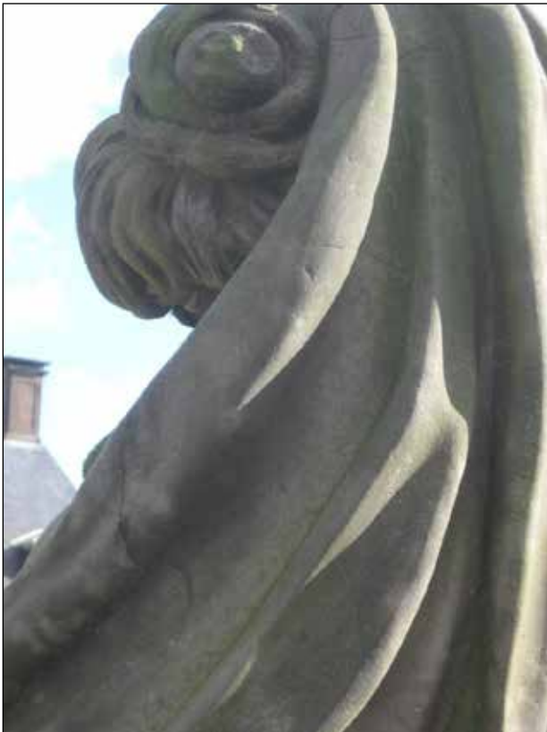
Figuur 5. Kleine barsten in de zandsteen van Prudentia.
