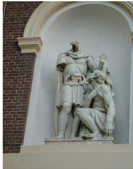
Figuur 23. Westwoud, RK kerk. Dit beeld van de heilige Martinus uit 1851 gemaakt door de Antwerpse beeldhouwer J.de Cuyper, aan de westgevel van de kerk verkeert in erbarmelijke staat door opengebarsten verflagen en vervolgens roestende verankeringen. Foto Hendrik Tolboom.
