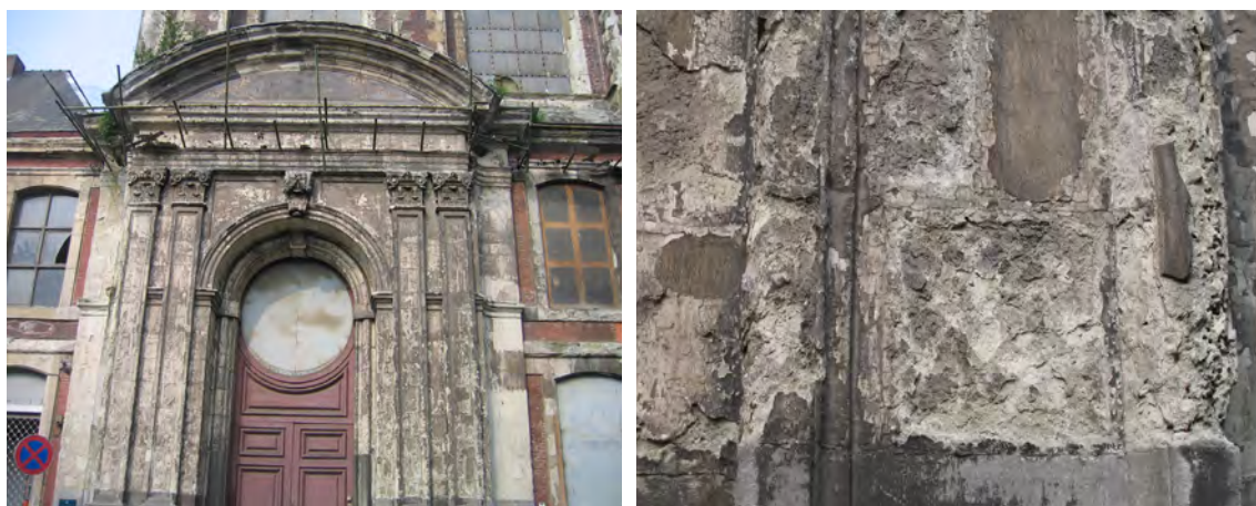
Figuur 15 en 16. Overzicht ingangspartij (15) en detail van de pilaster rechtsonder (16) van het voormalig Ursulinenklooster in Mons (Bergen ). Gevel opgebouwd uit Avendersteen. Stenen die oppervlakkig behandeld zijn en een harde korst gekregen hebben zullen bijzonder gevoelig worden voor snelle afbrokkeling en verpulvering wanneer nieuwe beschermstoffen op de oude worden aangebracht en het product niet meer doordringt (getuige de bruinverkleurde afbrokkelende buitenlaag). Bij waterinfiltratie achter de harde korst ontstaat een oplossingszone die de binding van de korst teniet doet zodat de steen op korte tijd kan eroderen en een amorf uitzicht krijgt. Foto's van Jan Elsen.
