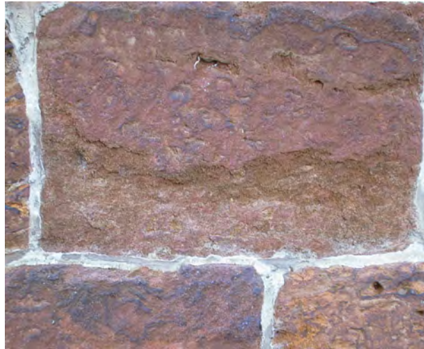
Figuur 5. Diestiaanse ijzerzandsteenblok waarvan de harde oppervlaktehuid deels is afgestoten. (Testelt, Sint-Pieterskerk)
