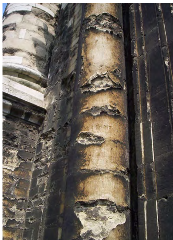
Figuur 2. Gipskorsten op Lede, Eglise St. Jean et St. Etienne des Minimes, Brussel (jul. 2004).
