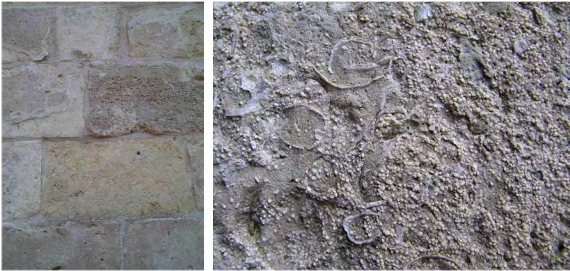
Figuur 3. Ledesteen dominant aanwezig in de Sint-Martinuskerk te Lede en detail van de Ledesteen in de Sint-Bavokerk te Mere (Erpe-Mere).
