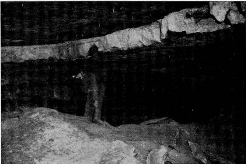
Photo 1 : Entre des strates dont le décollement était dangereusement amorcé.
