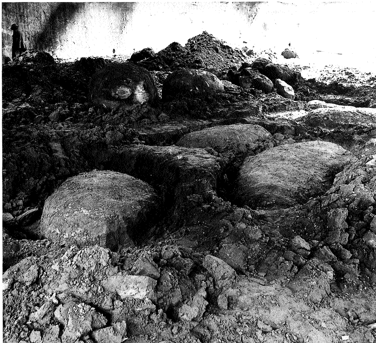
Figuur 14. Rupeltunnel te Boom: kalkzandsteenconcreties in de bouwput; de figuur op de achtergrond geeft de schaal aan (foto geleverd door P. Laga)
