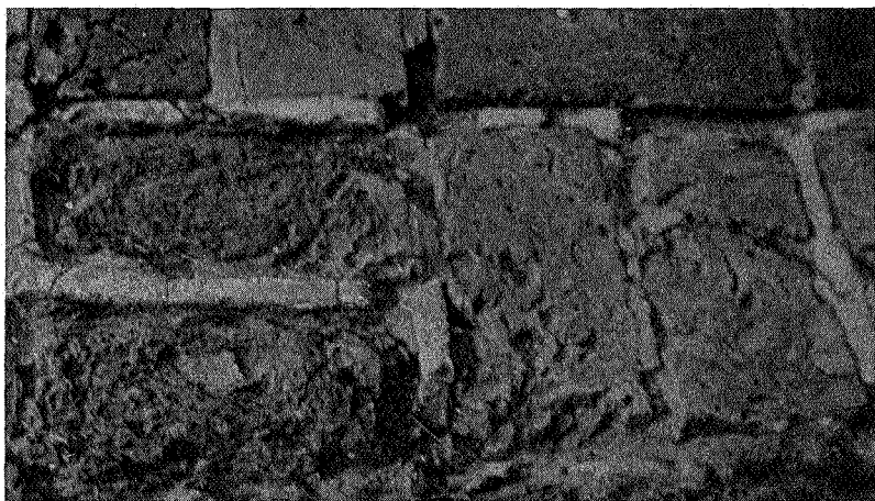
FIG. 7. — Gélivité des briques mécaniques ordinaires de Boom (pavement).
