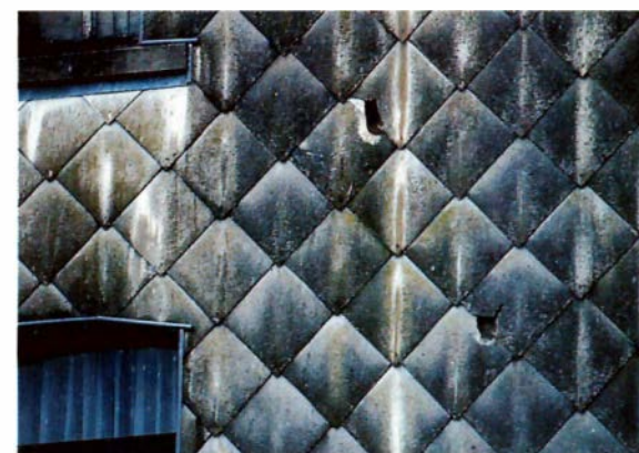
© Trous dans le bardage d'un bâtiment abritant une colonie de pipistrelles (J. Fairon, CRC-I.R.Sc.N.B.)
