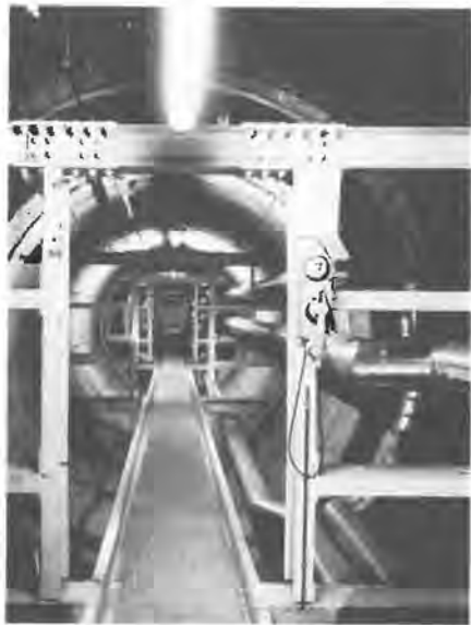
Fig. 4 : Vue de l'envoyage à la sortie de l'ascenseur. On remarque le câble coaxial et le téléphone
