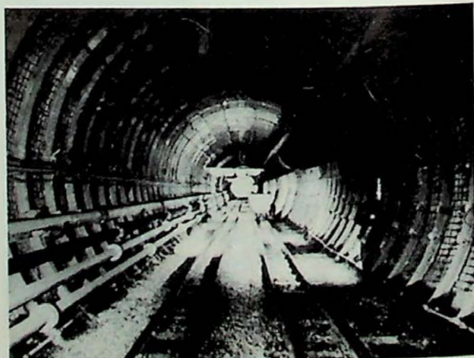
Fig. 8 : Soutènement circulaire de galeries au rocher creusées en Allemagne au moyen d'un tunnelier
