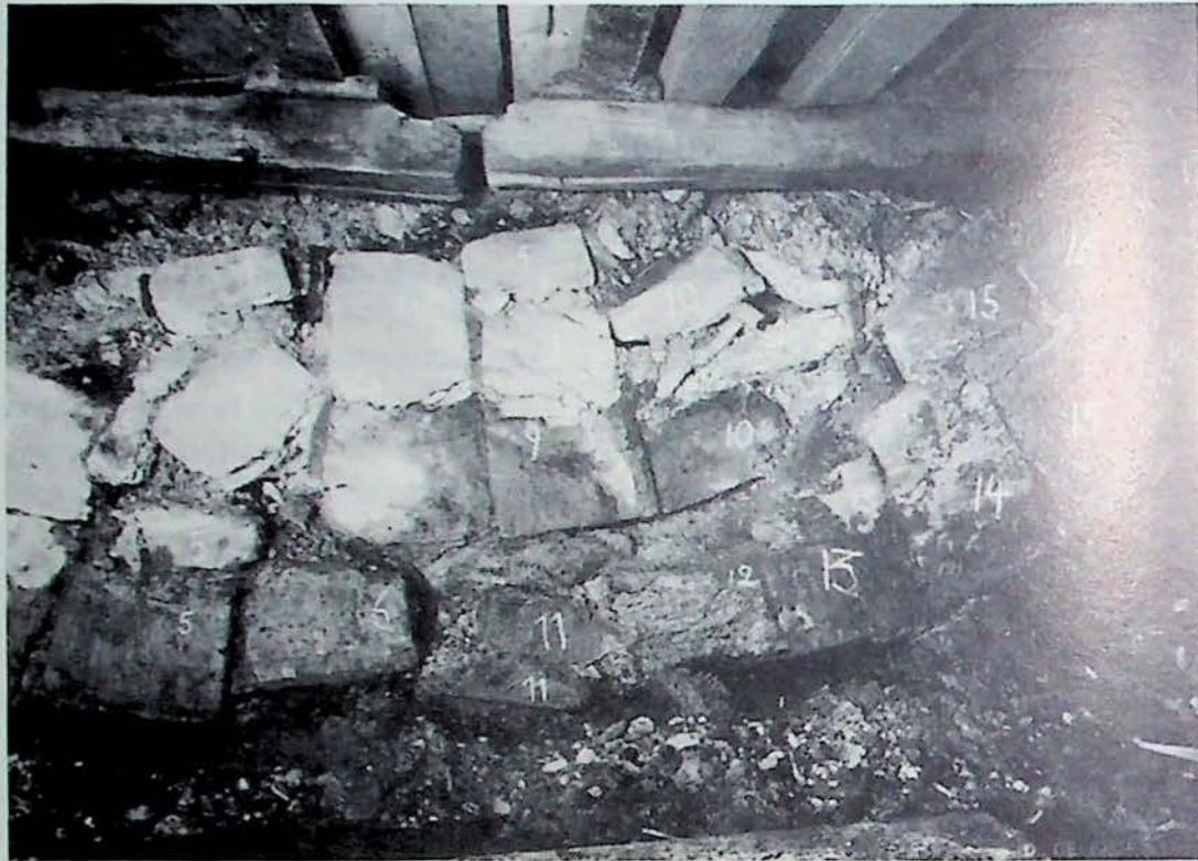
Fig. 4. — Photographie prise dans le radier d'un bouveau à claveaux lors d'un recarrage. On remarque bien le raillage du bouveau dans le haut de la photo. Les claveaux 7 - 8 - 9 et 10 ont été éjectés par une poussée orientée de bas en haut. Ce déboîtement a pu se produire grâce au cisaillement des claveaux et à l'écrasement des intercalaires compressibles.
