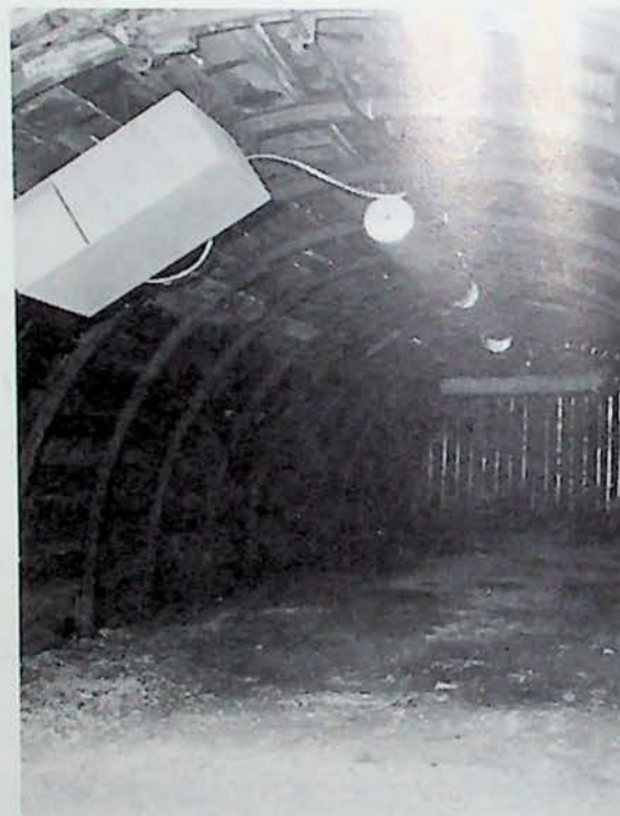
Fig. 23. — Opstelling in een galerij van een detector verbonden met een rij bluselementen.
