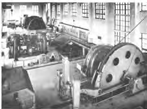
S.A. des Charbonnages du Borinage. — Salle des machines d'extraction du siège de Tertre.
