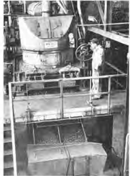
S.A. des Charbonnages de l'Espérance et Bonne-Fortune. — Fabrique d'agglomérés de houille - Presse à boulets. S.A. des Charbonnages de l'Espérance et Bonne-Fortune. — Kolenagglomeratenfabriek - Eierkolenpers.
