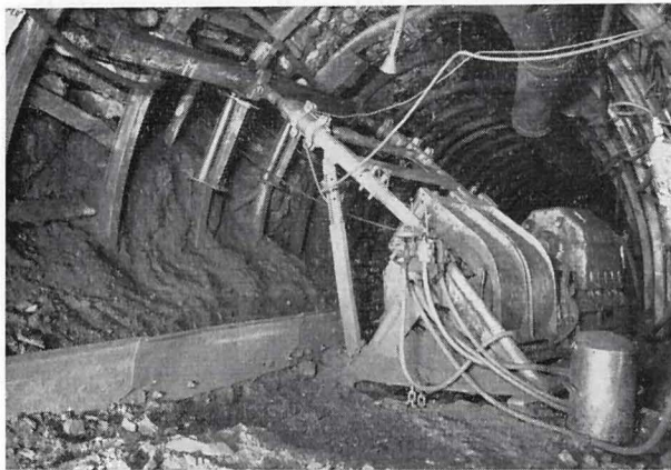
Fig. 2. — Siège n° 23. — Treuil électrique « Escol » de 40 kW.
