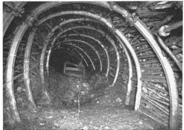
Fig. 18. — Siège n° 23. — Voie de tête équipée d'un scraper-houe (remise en état).
