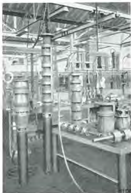
Fig. 4. — Deux groupes moto-pompes Stork placés dans leur position de travail.
