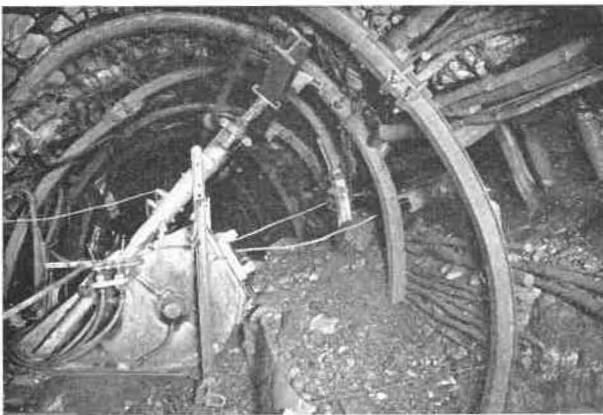
Fig. 20. — Vue montrant la disposition du treuil dans la voie de base. On distingue nettement les commandes pneumatiques des freins et des embrayages, ainsi que le dispositif de calage télescopique du treuil.
