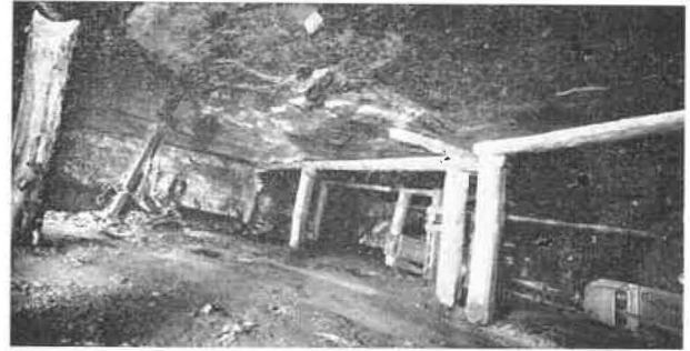
Fig. 21. — Vue de la tête de taille. On remarque l'étau métallique auquel est amarré le palan à chaîne Galle servant à riper la poulie de renvoi. On distingue également une partie de la poutrelle à laquelle est amarrée cette poulie et la partie supérieure du train de caisses.
