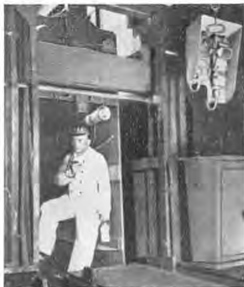
Fig. 29. — Disposition de l'appareillage de téléphone dans la cage.
