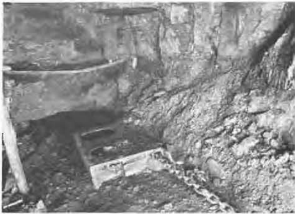
Fig. 18. — Vue du dérangement, la présence d'eau en grande quantité dans le toit a provoqué la chute de celui-ci. Le scraper entamaît le mur, 1 mètre en dessous de la veine.
