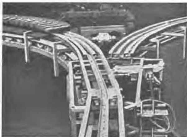
Fig. 13. — Aiguillage et interrupteurs magnétiques de commande des têtes motrices du convoyeur navette Hemscheidt.
