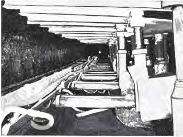
Fig. 8. — Architecture du soutènement. Actuellement le soutènement de la taille est renforcé par une file d'étançons hydrauliques Dowty disposés le long du convoyeur (entre le convoyeur et les piles). Ces étaux ne sont pas visibles sur la photographie.
