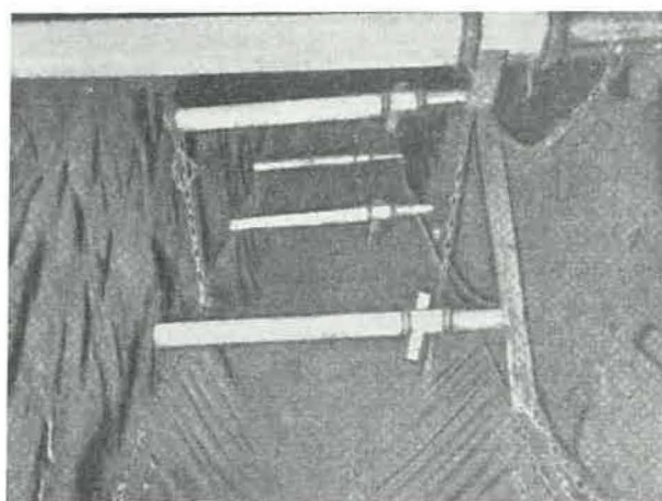
Fig. 9. — Vue du treillis métallique de bas en haut dans la taille. Soutènement avec étaçon Alco I en alliage léger et plate-belle placée suivant la pente,
