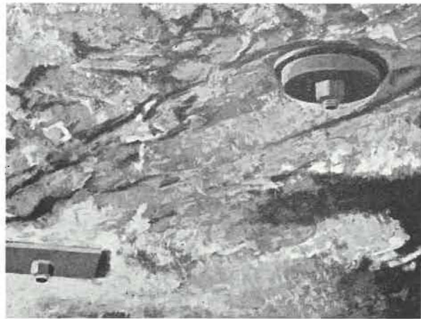
Fig. 24. — Tampon de compression en place.
