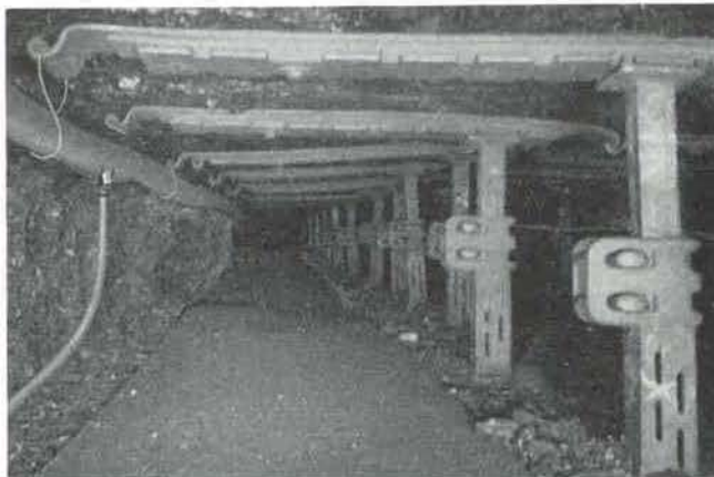
Fig. 13. — Conduite flexible suspendue à l'extrémité des bèles Schmidt (ouverture 65 cm)
