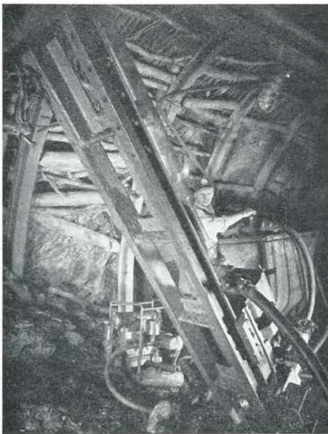
Fig. 7. — Sondeuse Nüsse et Gräfer en activité pendant l'amorçage d'un sondage en forage carottant \varnothing 111 mm. On aperçoit le tube carottier pénétrant dans la roche et la position modifiée de la clef d'assemblage des barres de forage.
