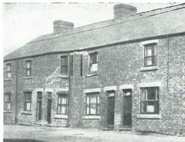
Fig. 3. — Dommages typiques à des maisons contiguës. Il est à remarquer que les maisons à droite ont eu leur façade complètement reconstruite.
