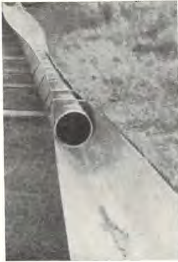
Fig. 4. — Préconformation en auget de la bande métallique par courbure autour d'un tuyau de 50 cm.
