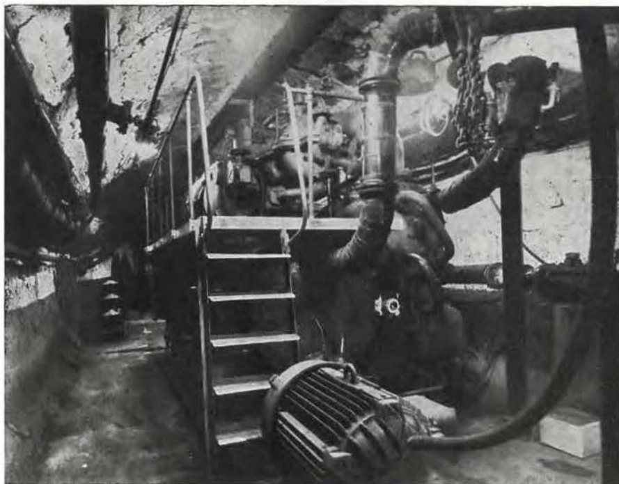
Fig. 8. — Installation de réfrigération souterraine du Charbonnage des Liégeois. Machine frigorifique.
