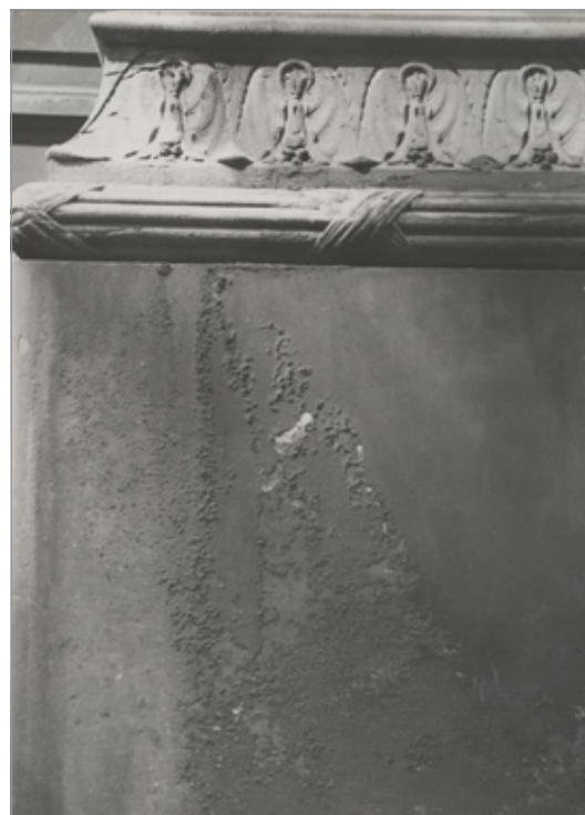
Afbeelding 51 Detail van vervuilde gevel (steen van Larochette), Nationale bank, Brussel (Camerman, s.d.).
