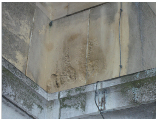
Afbeelding 15 Schadebeeld onder de vorm van alveolen op Luxemburgse zandsteenblokken net boven een uitstekende dorpel (foto: Origin).
