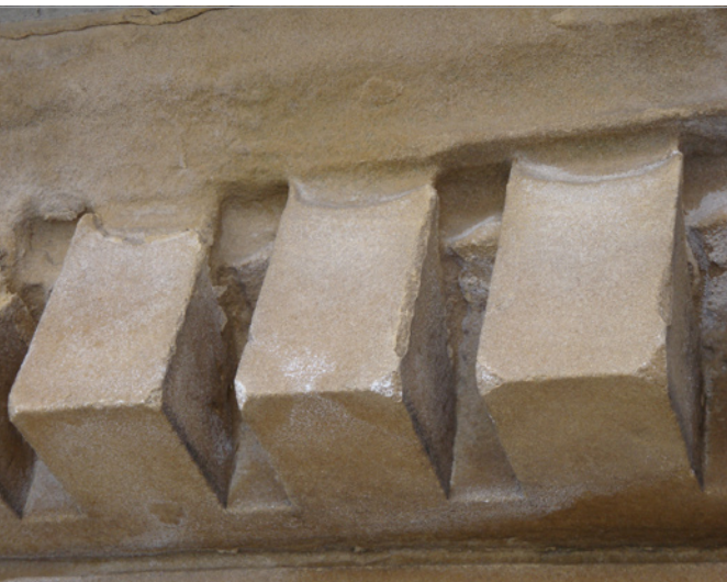
Afbeelding 11 Zone onder de kroonlijst met beschadigde tanden. Tevens wordt zoutuitbloei bemerkt (foto: H. De Clercq).
