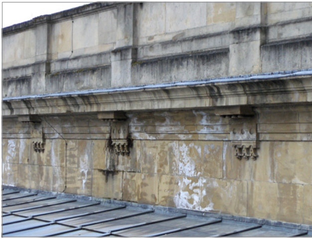
Afbeelding 12 Algemeen schadebeeld van het geveldeel onder de kroonlijst als gevolg van defecten in het waterafvoersysteem (foto: Origin).
