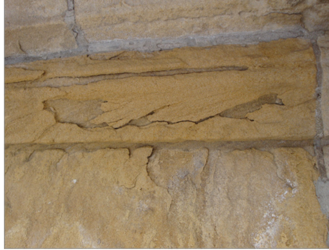
Afbeelding 13 Typerend schadebeeld van een steenblok in het geveldeel onder de kroonlijst. Naast intense zoutuitbloei wordt afstoting van de oppervlaktelaag vastgesteld (foto: H. De Clercq).
