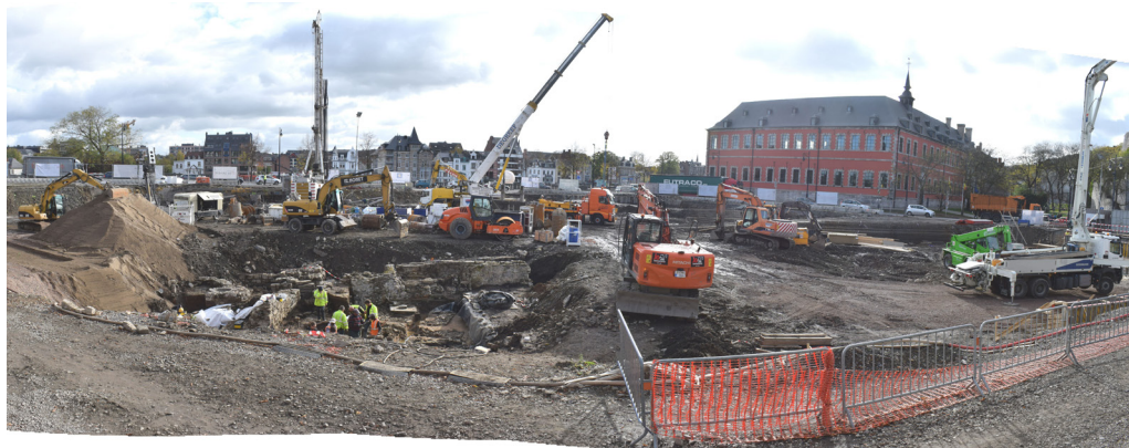
Fig. 2 – Le Grognon à Namur : la cohabitation, ou trop d'équipes, de machines, de camions, de zones de stockage et de rampes d'accès, lors de la fouille du sanctuaire romain (à l'avant plan de la vue ; photo et panorama : D. Bosquet, © AWaP).
