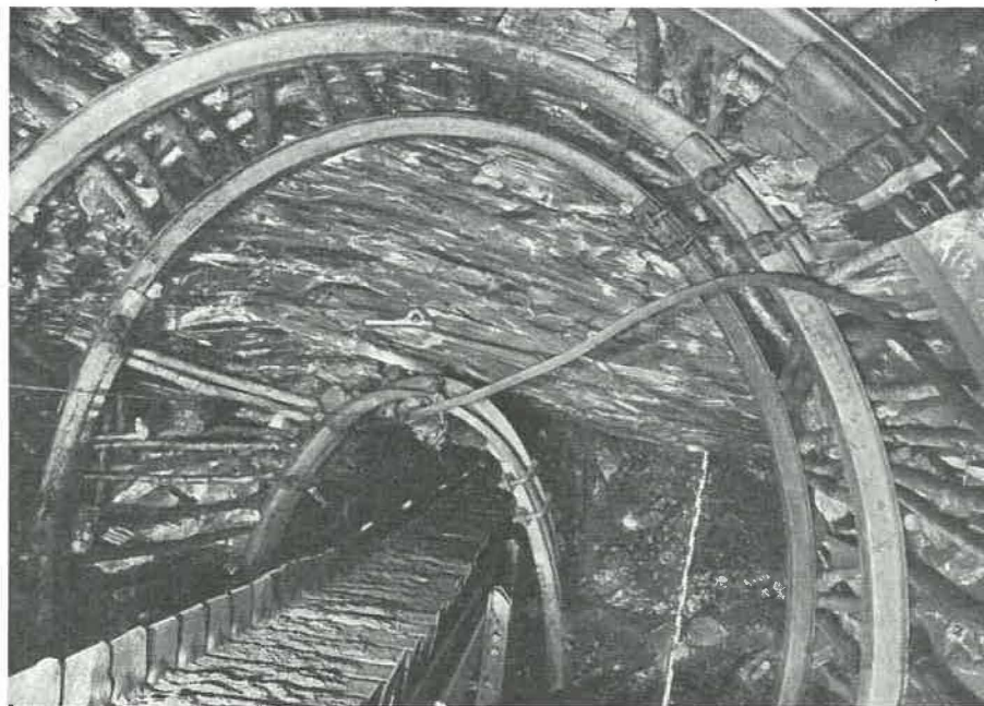
Fig. 2. — Brèche de recarrage dans la zone revêtue de cadres coulissants.
